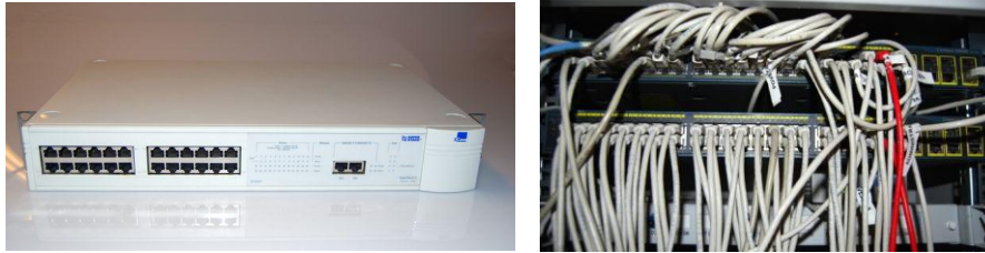
Slika 12: Stikalo (levo) in stikalo s kabli, ki povezujejo računalnike (desno).
