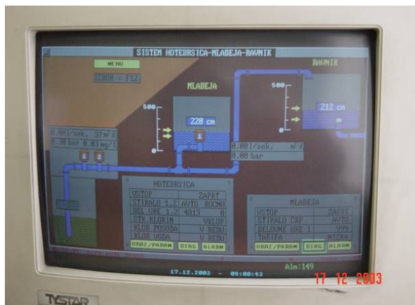
Slika 95: Nadzor delovanja vodovodnega sistema Vir: Lasten
