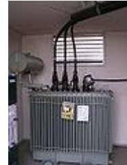
Transformator 20 kV auf 400/230 V
