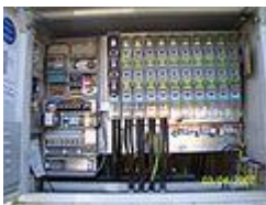
Niederspannungsseite einer fernbedienbaren Trafostation der EVN
