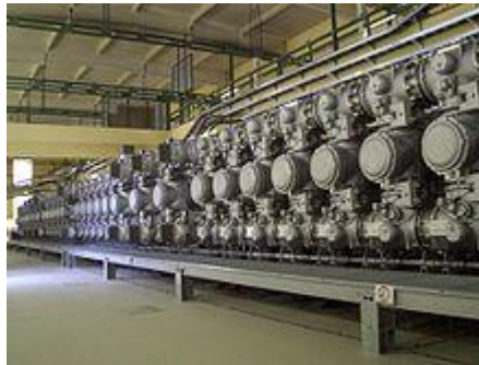
Abb. 15: Gasisolierte Schaltanlage für 110 kV im Umspannwerk Simmering
