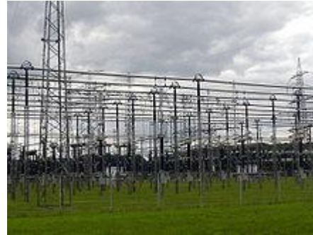
Freiluftschaltfeld bei dem Kernkraftwerk Grafenrheinfeld
