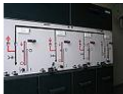
SF 6 -Schaltanlage für 20 kV
