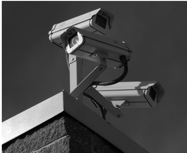
Slika 4: Nadzorne kamere na strešnem vogalu stavbe
