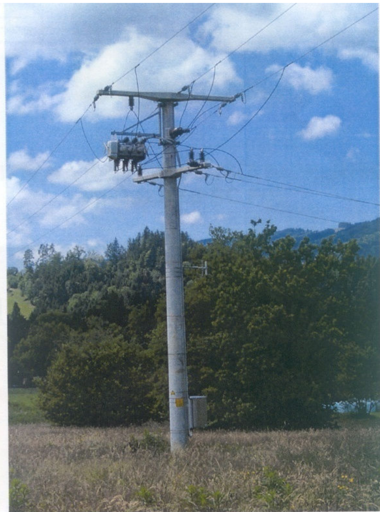
Slika 53: Ločilno mesto z daljinsko vodenim bremenskim stikalom na betonskem drogu
