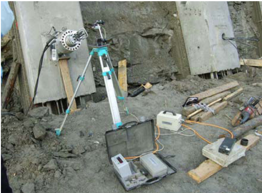
Slika 58: Preizkušanje sidra se izvaja s pomočjo merjenja vnešene sile, merjenja pomikov in merjena opazovalnega časa
