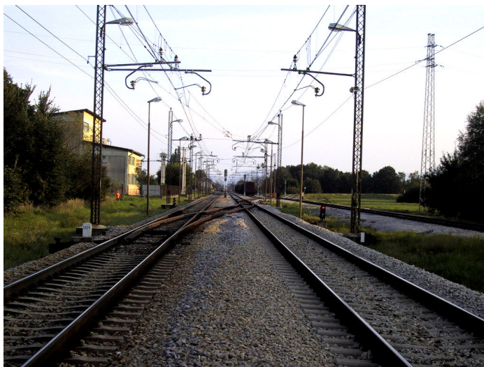
Slika 13: Električni vodi za električno napajanje lokomotiv in električnih vlakov Vir: Lasten.
